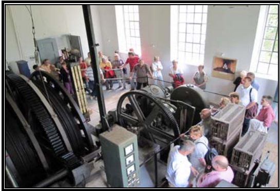
Bild 4: Maschinenraum im „Drei-Brüder-Schacht“
